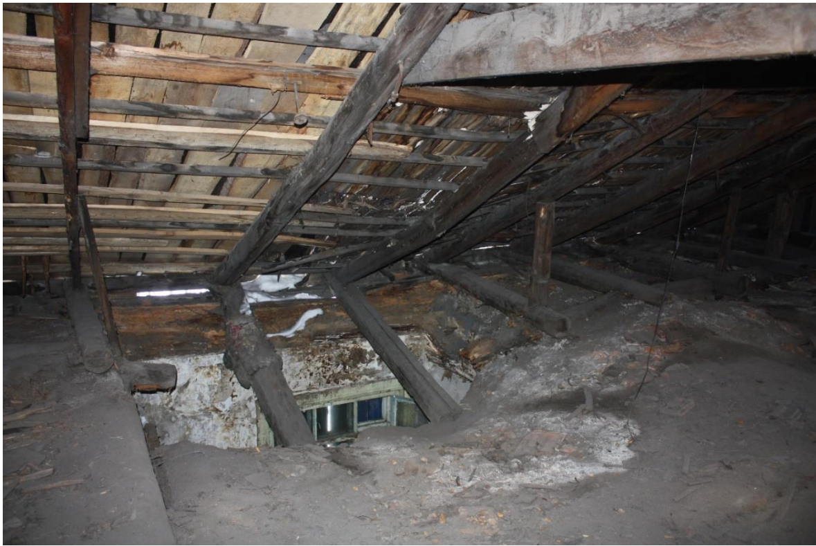
Рисунок 7.41 – Потеря устойчивости стропильной системы.
