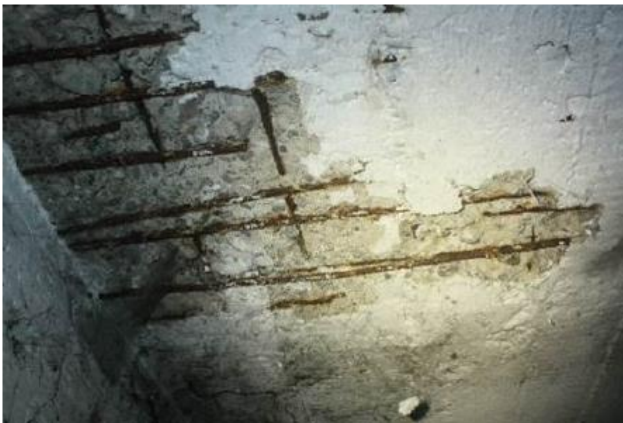
Рисунок 7.53 – Отслоение защитного слоя бетона плиты перекрытия.
