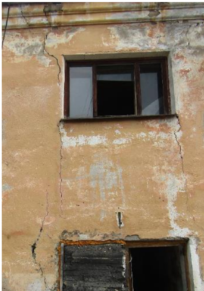
Рисунок 7.4 – Трещина в стене из шлакоблока шириной раскрытия более 5 мм.
