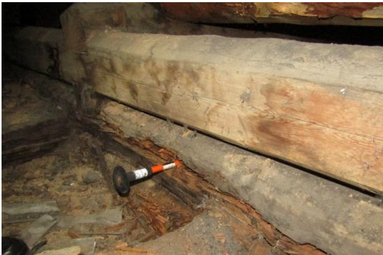
Рисунок 7.49 – Поражение гнилью деревянной стены
