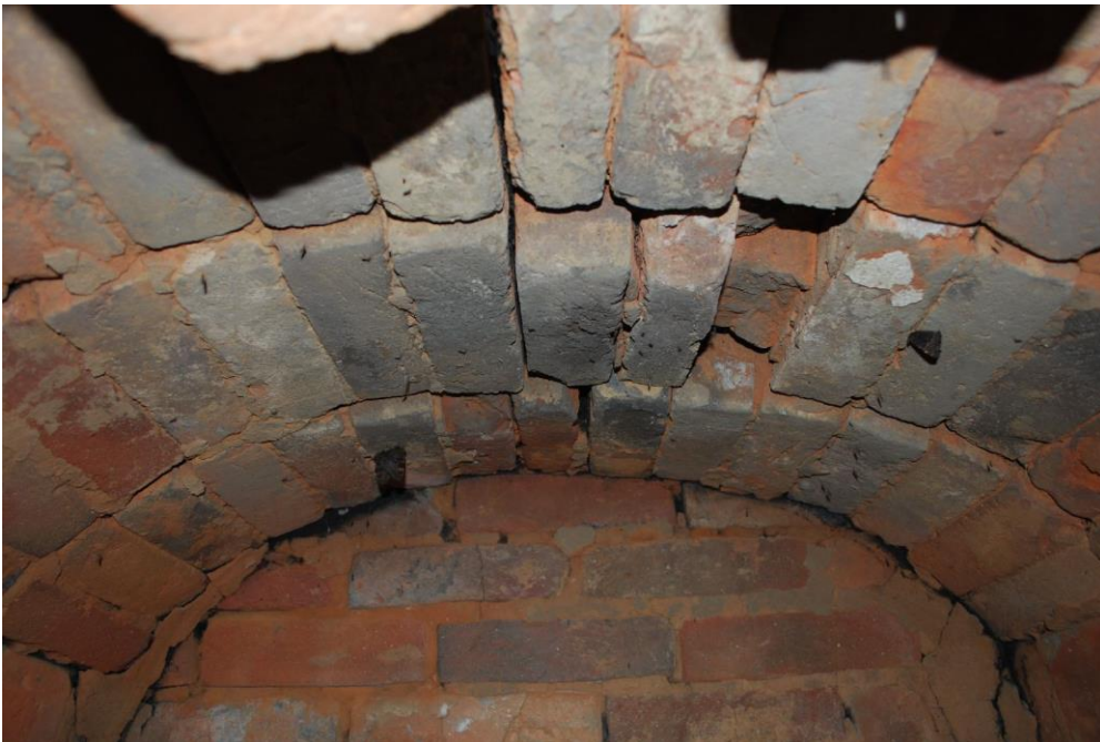
Рисунок 7.56 – Выпадение камней из кирпичной кладки сводов
