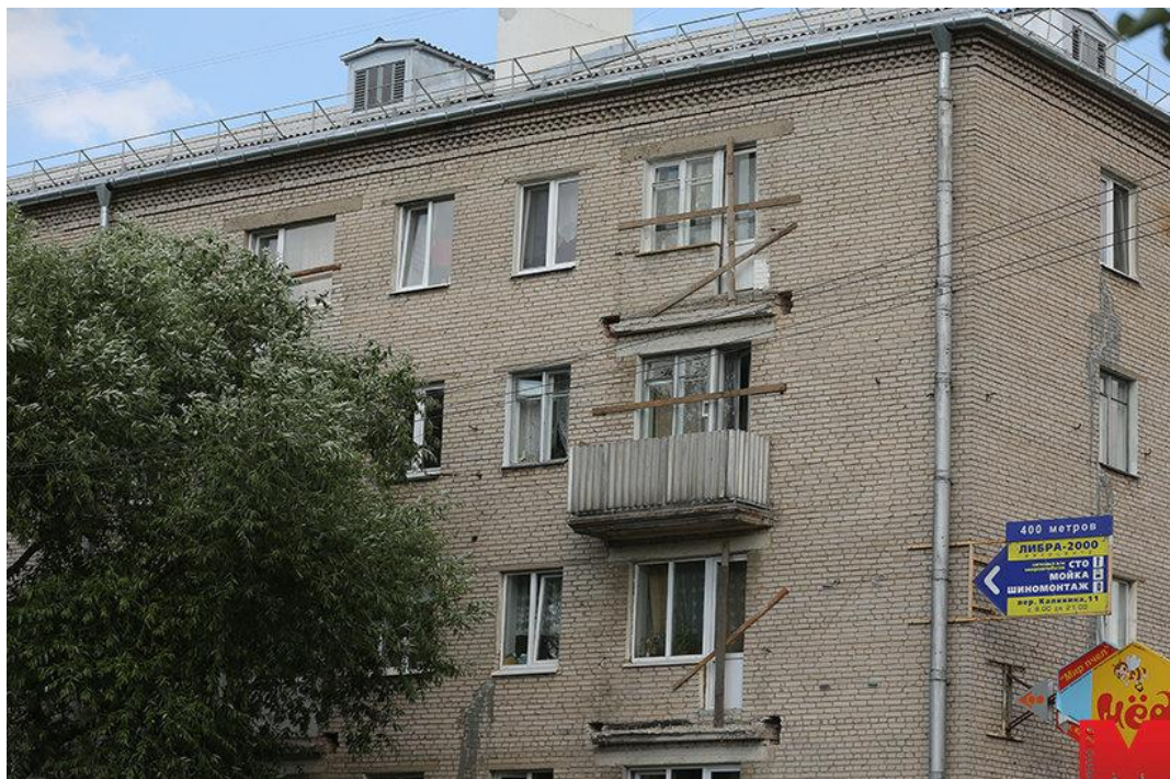
Рисунок 8.1 – Жилое четырехэтажное здание со срезанными балконами: г. Минск, ул. Калинина, 22.
