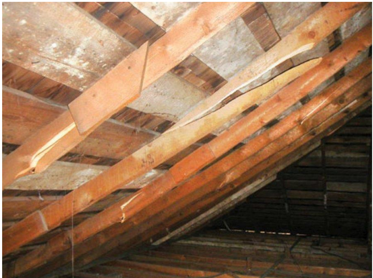
Рисунок 7.6 – Трещины в деревянных стропилах.
