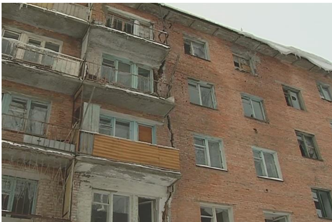
Рисунок 8.4 – Сквозная вертикальная трещина на всю высоту простенка пятиэтажного кирпичного здания
