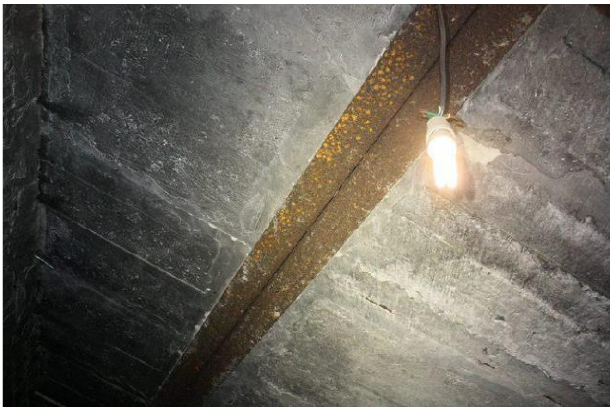
Рисунок 7.50 – Коррозия балки перекрытия
