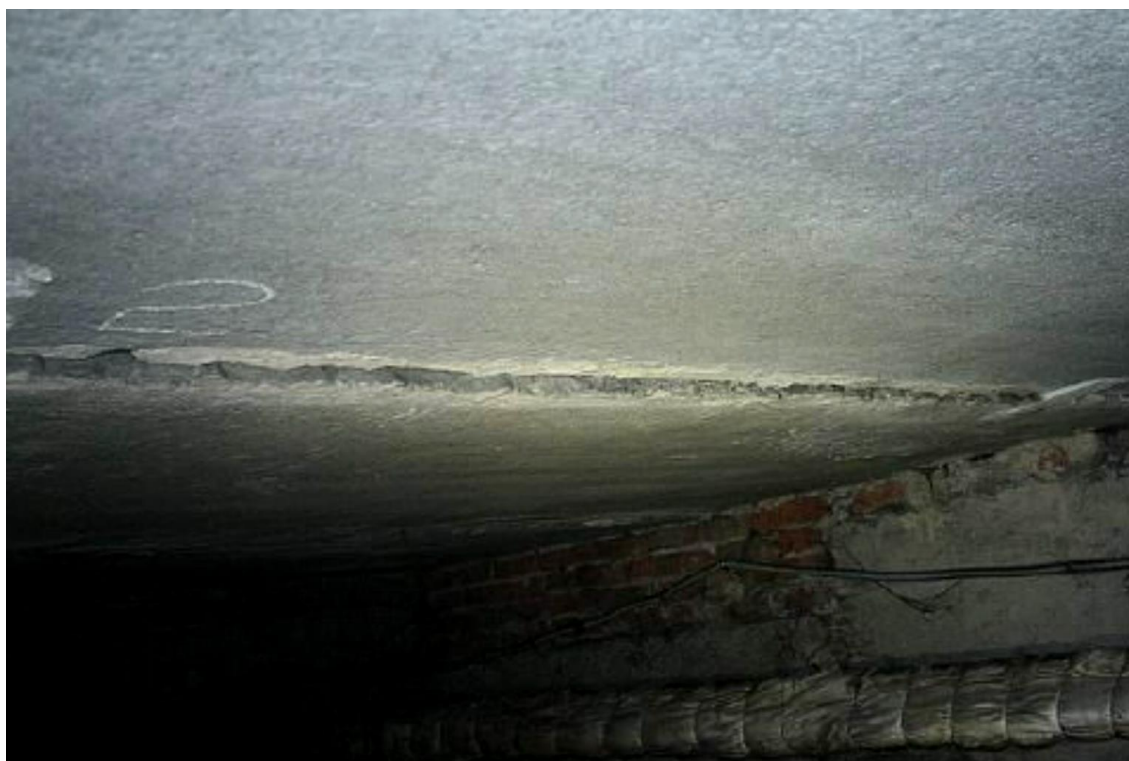
Рисунок 7.28 – Прогиб ж/б плиты перекрытия.
