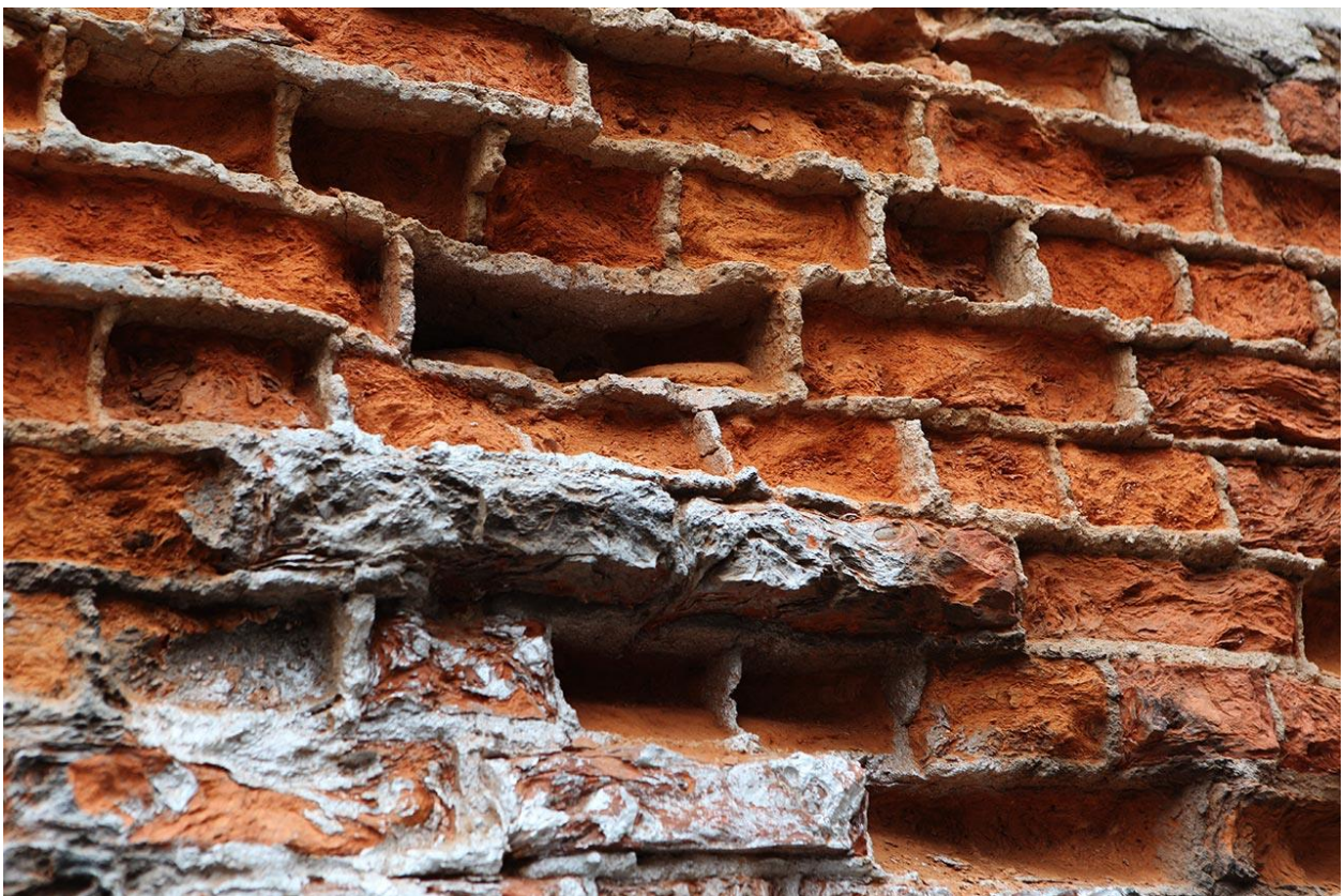
Рисунок 7.48 – Разрушение кирпичной кладки
