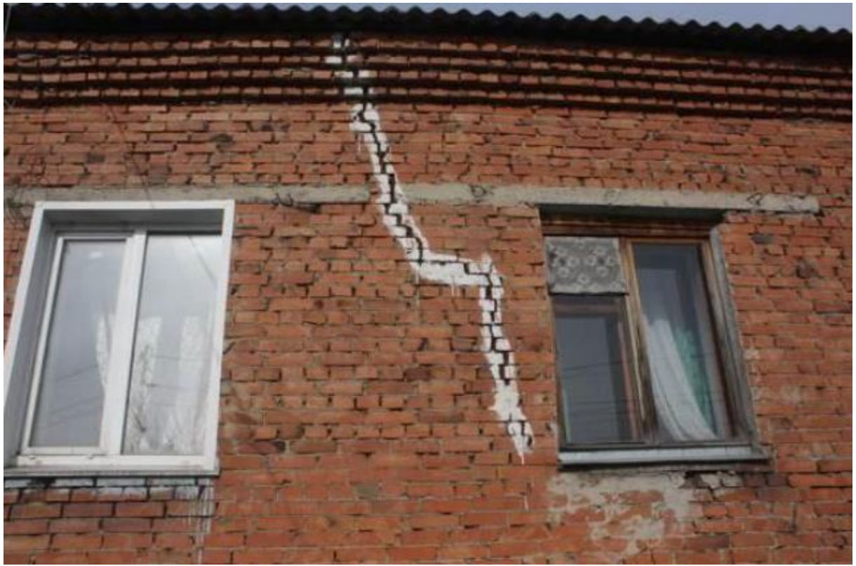
Рисунок 7.5 – Трещина в кирпичной кладке.
