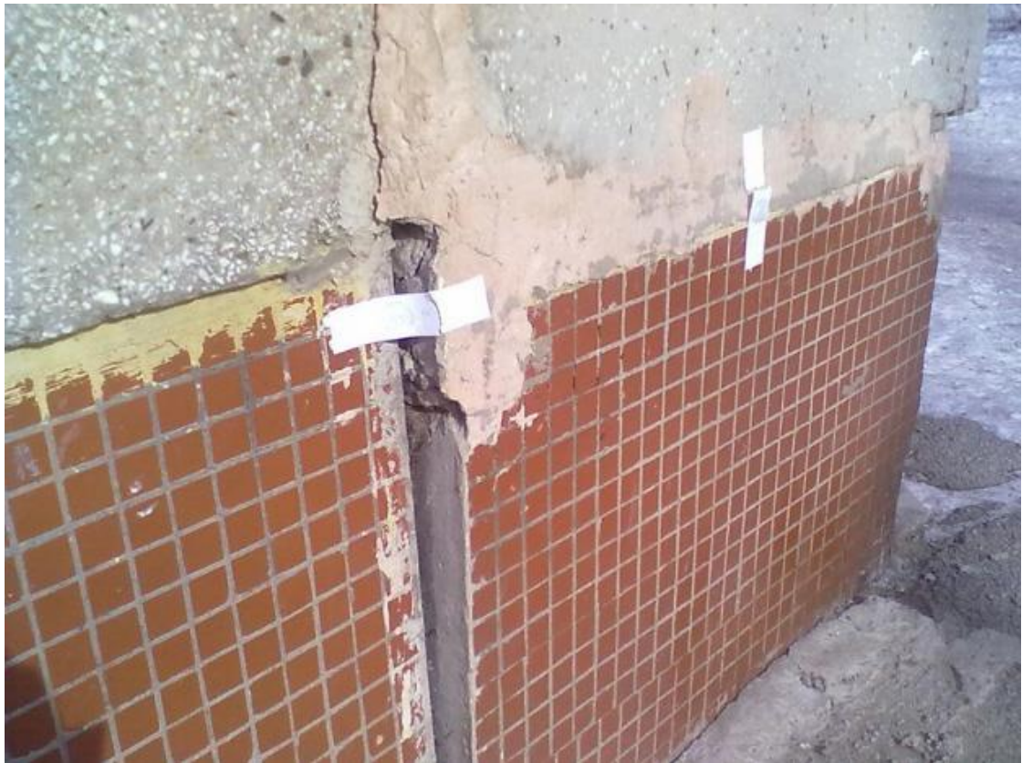
Рисунок 7.40 – Смещение стеновой панели из плоскости стены.
